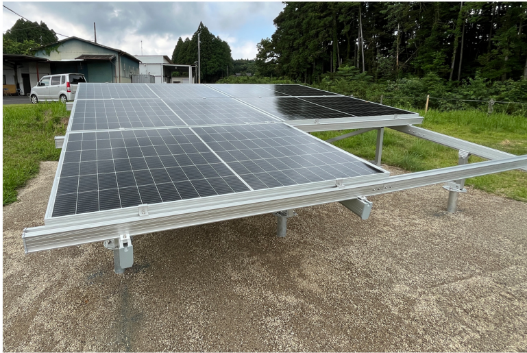
2250W出力検査用ソーラーパネル
